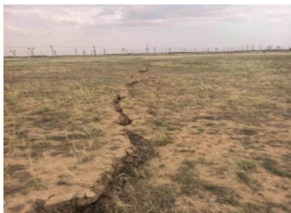
照片 4-2 地裂缝治理前照片
